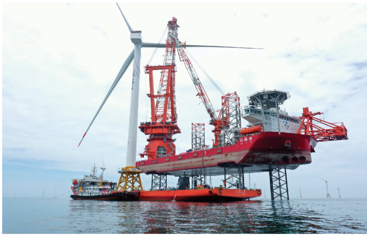
全球首台16兆瓦海上风电机组今年6月在福建北部海域顺利完成吊装,7月19日在福建海上风电场并网发电。标志着我国海上风电高端装备制造能力、深远海海上风电施工等全产业链实现整体提升,达到国际领先水平。
